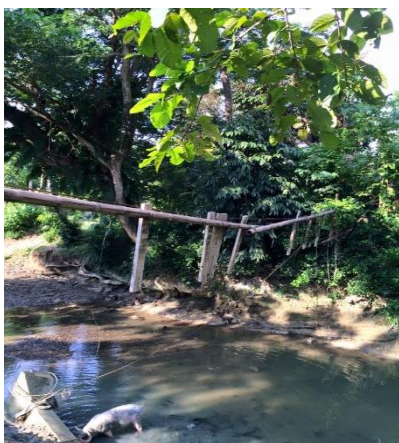
台風で壊れた橋
