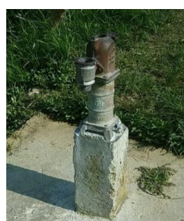
井戸付近の壊れたポンプ
