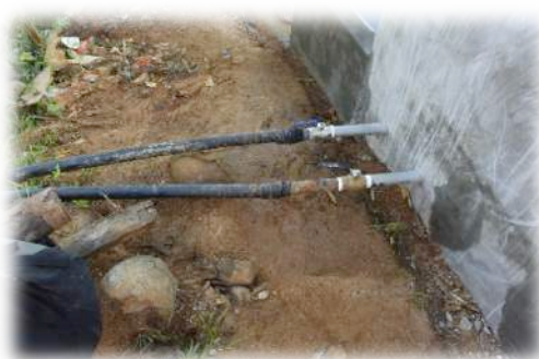
タンクから接続された2本のパイプ
