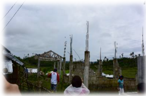
壊れた BRGY hall
